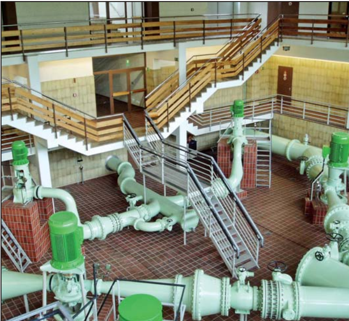
15 Wasserwerke betreibt der OOWV in seinem Verbandsgebiet – das größte befindet sich in Großenkneten.
