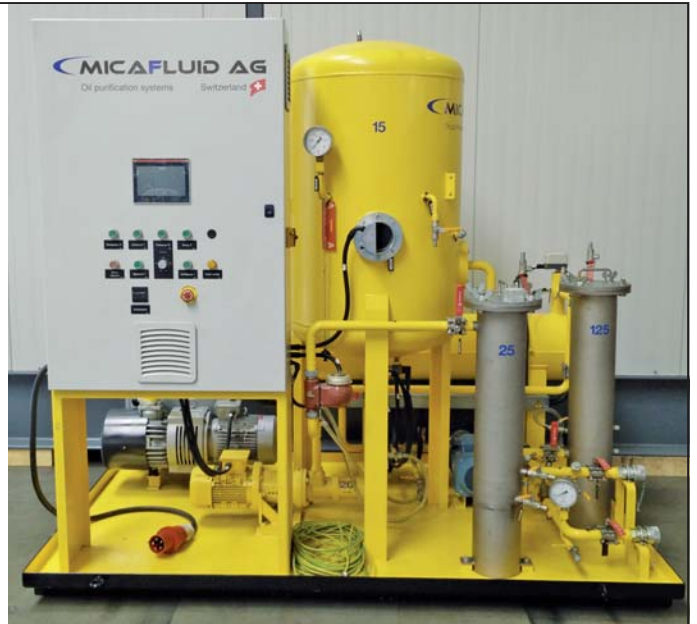
Mobile Ölaufbereitungsanlage Mobile oil treatment plant
