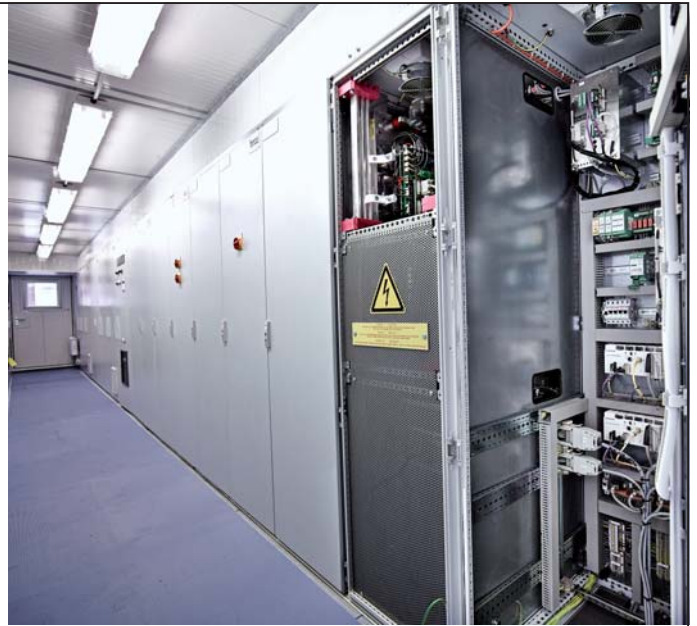
Elektrotechnische Anlagen und eine Vielzahl anderer Services ergänzen das Leistungsspektrum.
